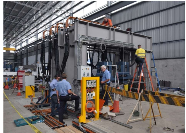
(d) Hydraulic pipe system
