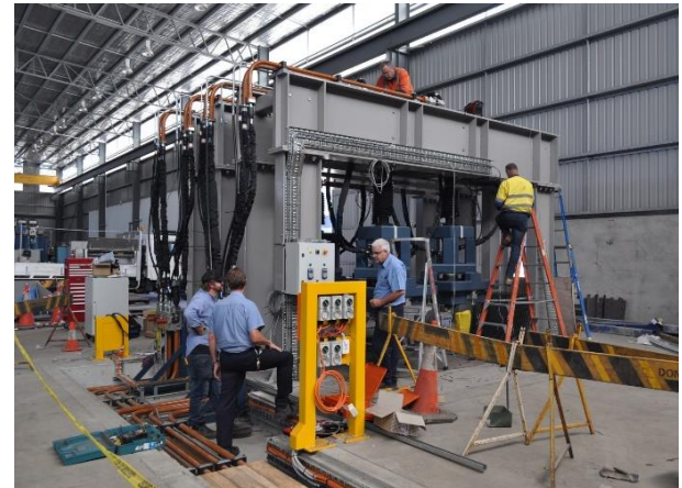
(d) Hydraulic pipe system
