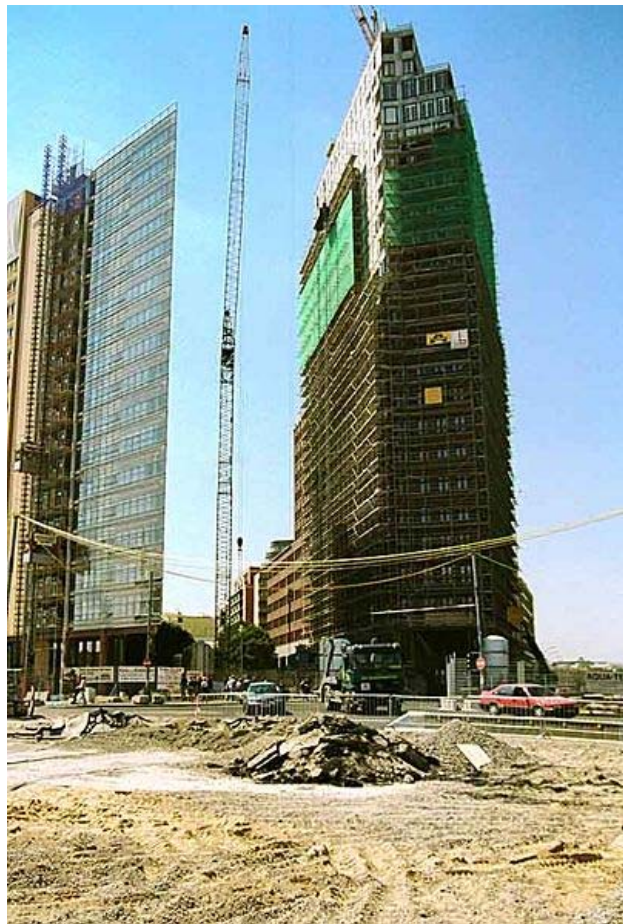
Figure 7. The Kolhoff tower under construction, Potsdamer Platz, 1999. Photo: Roger Koslowski ( http://de.wikipedia.org/w/index.php?title=Datei:Potsdamerplatz5.jpg&filetimestamp=20060712213306 ). Creative Commons.
